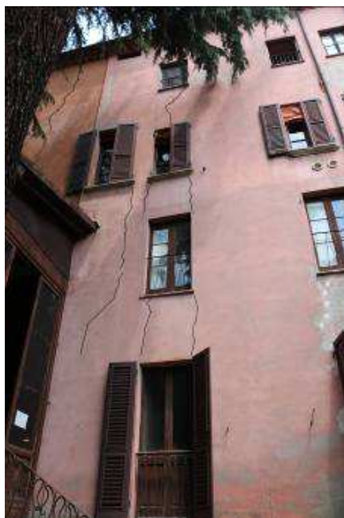
Figura 9. Palazzo Gulinelli, lesioni in una parete complanare all'allineamento di colonne del loggiato.
