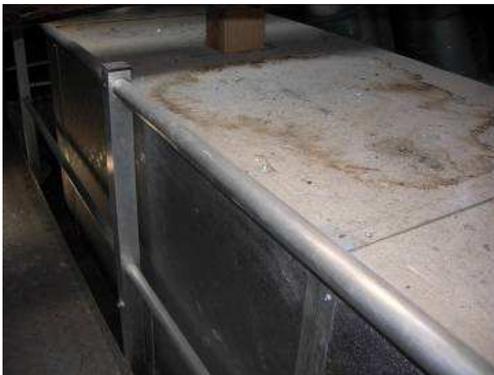
Figura 11. Unità di condizionamento dell'aria nel sottotetto di Palazzo Renata di Francia.
