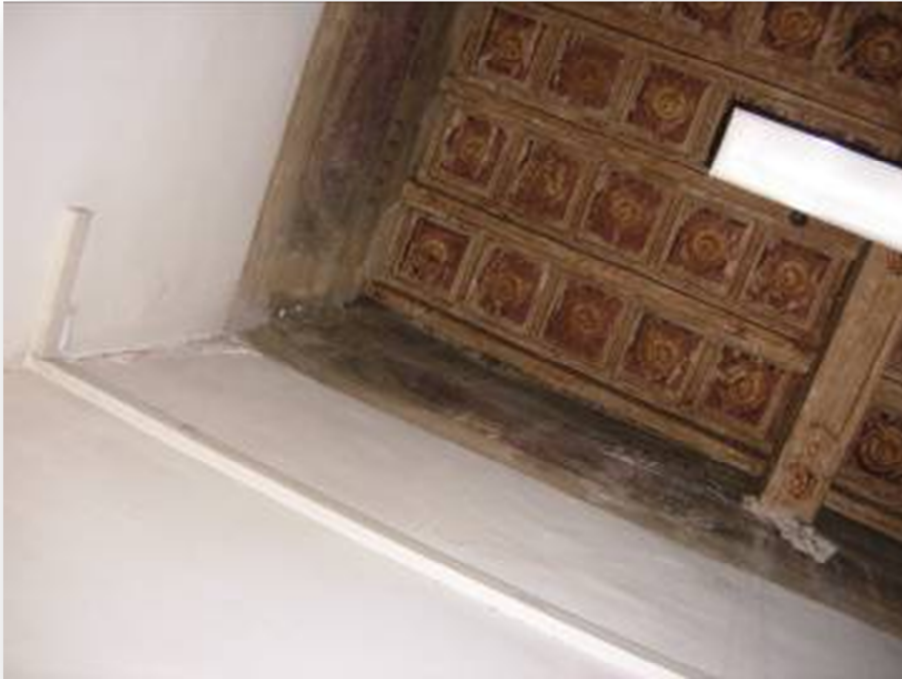
Figura 19. Palazzo Tassoni-Mirogli. Parziale sfilamento di una trave lignea dalla parete di supporto, localmente danneggiata a causa del martellamento. La stessa parete presenta lesioni agli incroci con le pareti ortogonali.
