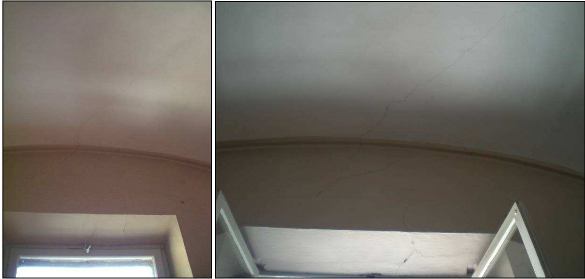
figura 5.5.2 - Lesioni su parete esterna Ala settentrionale centrale - piano primo: Foto n°40, 42
