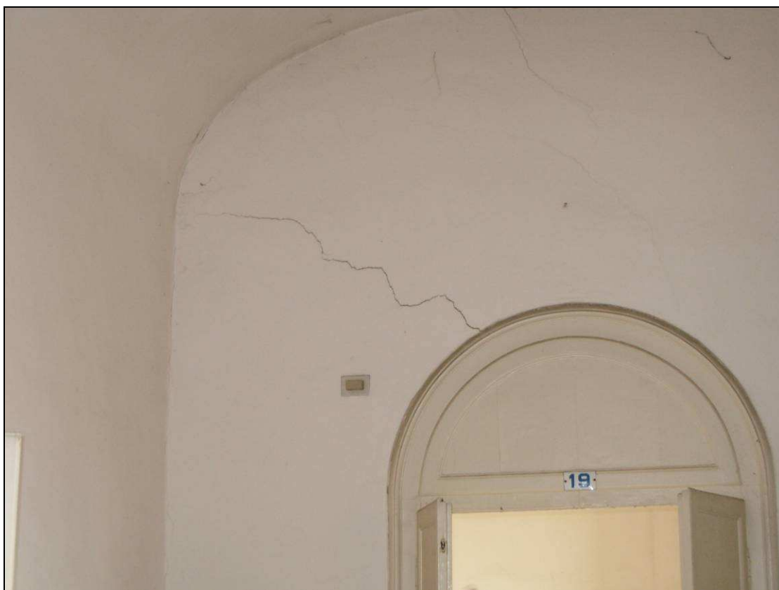
figura 5.5.4 - Lesioni su murature - piano secondo: Foto n°:35, 36
