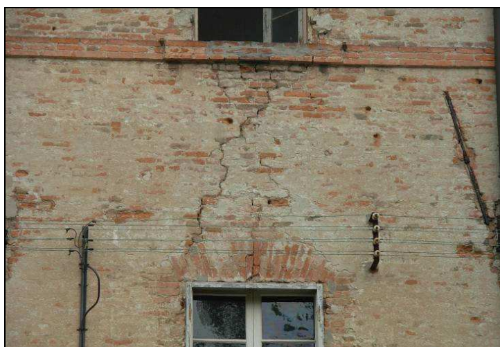
Figura 5.1.1 - Parete muraria sollecitata nel proprio piano: tipica rottura per taglio della fascia di piano (Foto n°1a - P.T.)
