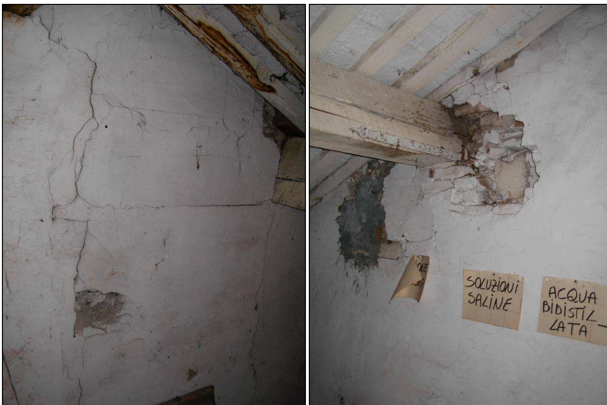
figura 5.5.5 - Lesioni su murature- piano secondo: Foto n°57, 58
