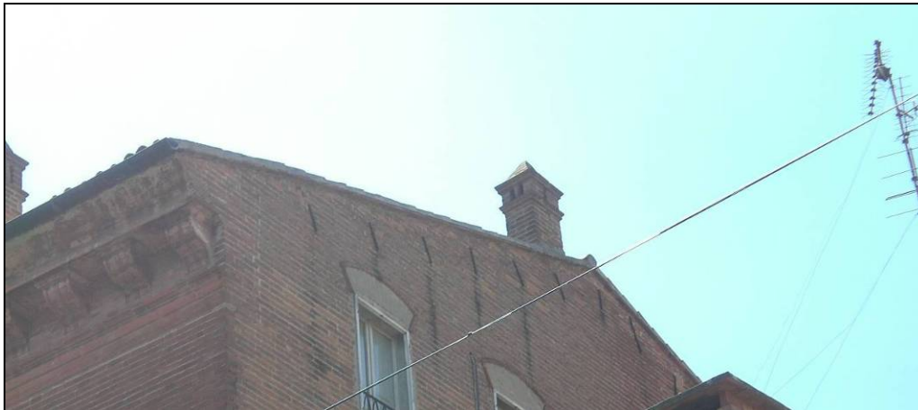
figura 4.4.5 - Tiranti su timpano a quota copertura (foto n°.4 esterna da piano rialzato)
